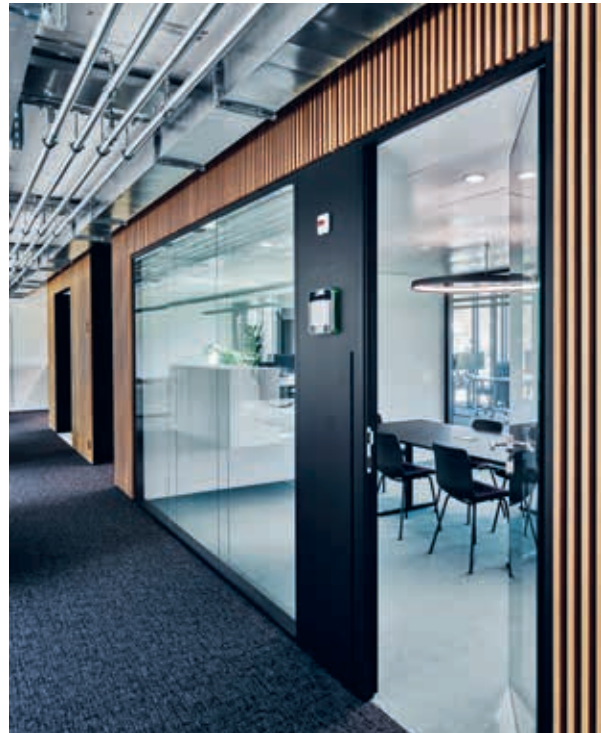
Technische Installationen bleiben sichtbar und machen Minergie-P auch im Innern des Gebäudes zum Erlebnis.
